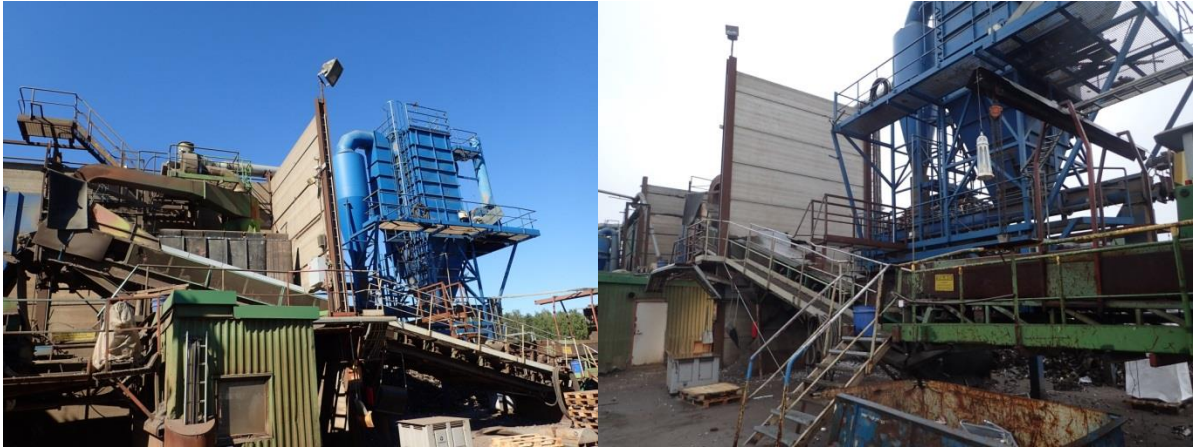
Kuvat 19 ja 20. Rengasmurskaimen pölynpoistoputki (neliömäinen putki vasemmanpuoleisen kuvan keskivaiheilla). Putken oikeanpuoleisessa päässä pölynpoistolaitteet järjestyksessä: vihreä ja sininen sykloni, sekä sininen pussisuodatin.
