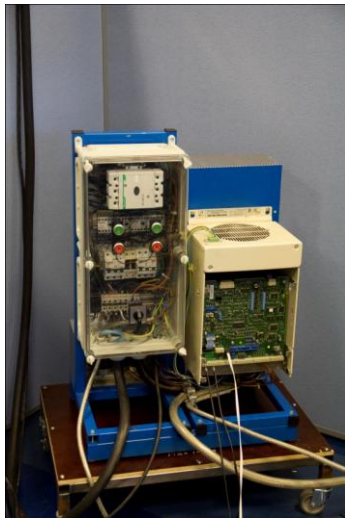
Kuva 6.5. ABB DCS500B tyristorisuuntaaja
