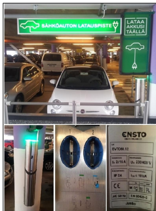
Kuva 9: Sähköauton latauspiste kauppakeskus Jumbon parkkipaikassa.
